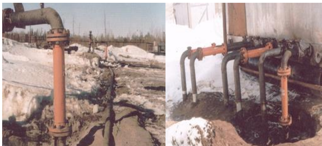
Рисунок 14 - Магнитные камеры на устье и на входе в АГЗУ
