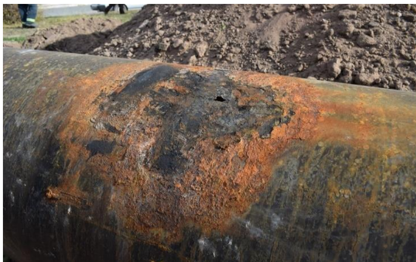
Рисунок 2.1.1 – Наружная, сквозная коррозия трубопровода
