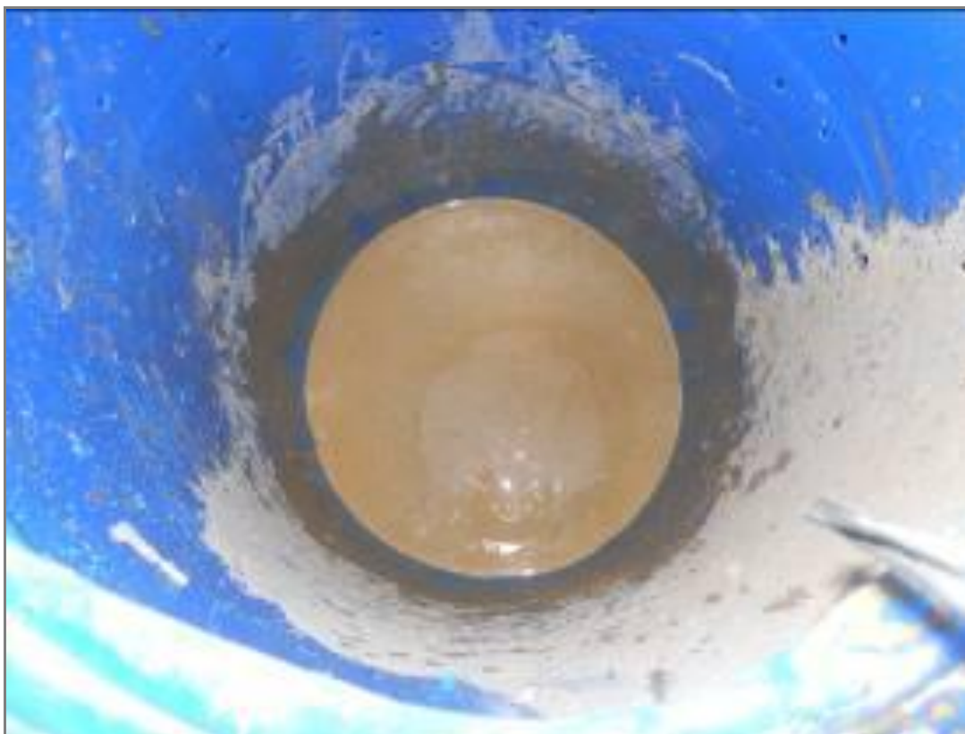
Рис. 6 Приток грунтовых вод через перфорированную полость корпуса МДУ (вид сверху), сентябрь 2011 г. (фото автора)
