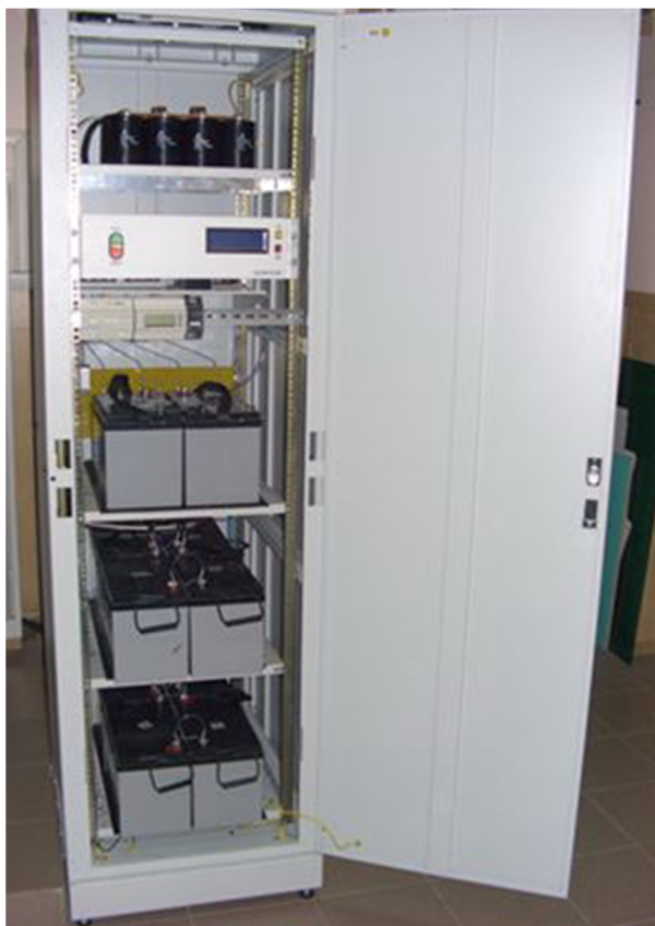
Рисунок 21 – Внешний вид экспериментального образца гибридной системы буферного накопления энергии ГСБНЭ-2/5-ШПТ. Вид спереди, передняя дверь открыта
