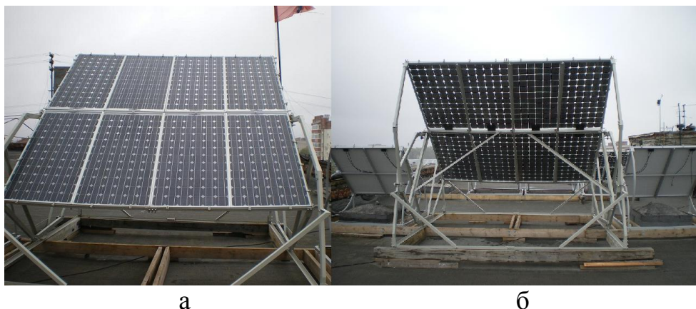
Рис. 2. Фотоэлектрическое устройство на подвижной раме (а – вид спереди, б – вид сзади)
