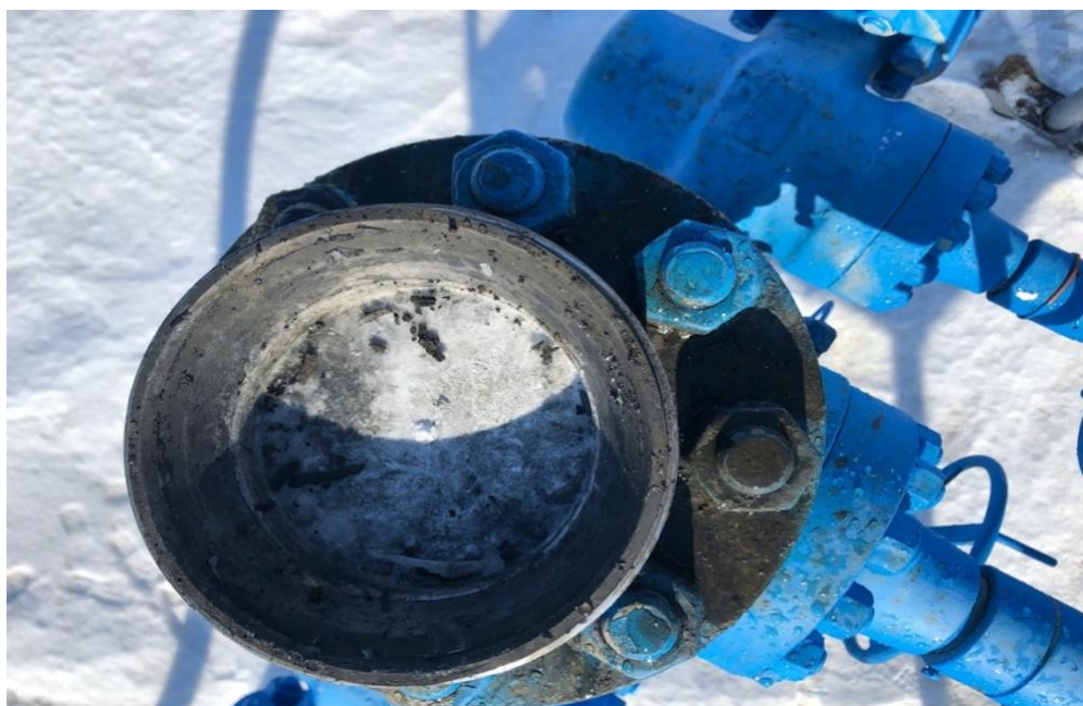
Рисунок 13 – Гидратная пробка на фонтанной арматуре
