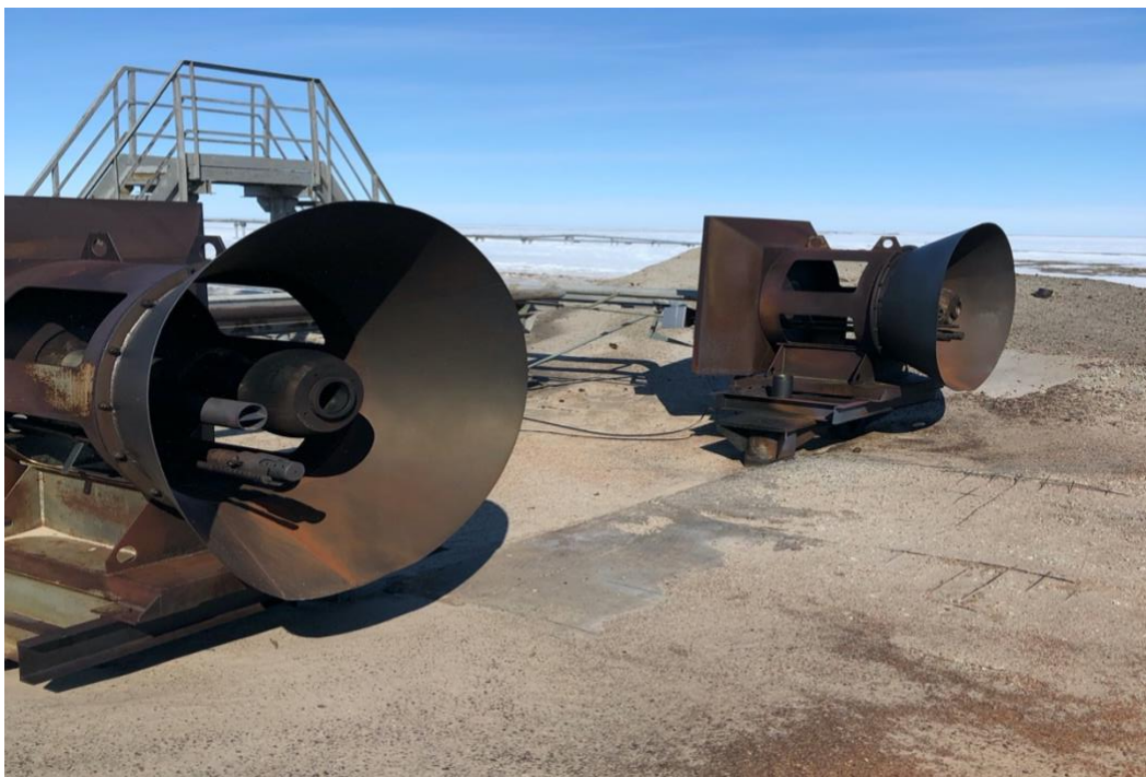
Рисунок 18 – Горизонтальная факельная установка
