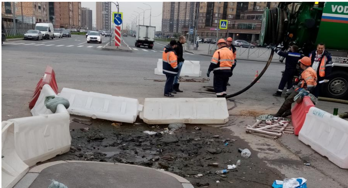
Рис.1. Провал грунта на участке аварии
