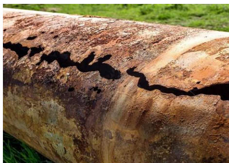
Рисунок 2 – Потеря металла при коррозии
