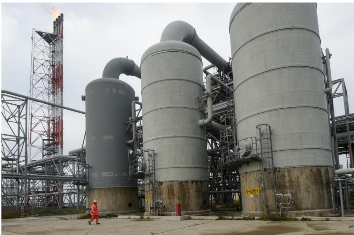
Рисунок 3 – Факельные сепараторы высокого давления
