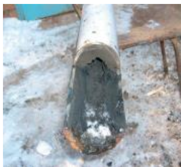
Рисунок 18 – Разрез водовода сточной воды на Мишкинском месторождении нефти с отложениями, состоящими из карбонатов, сульфатов, сульфида железа, АСПО, механических примесей
