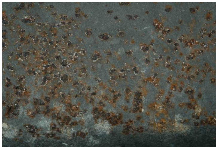
Рис. 4.4 – Язвенная коррозия на кровле
