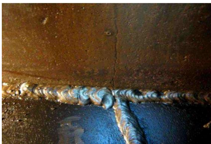
Рисунок 4.2 – Трещина в зоне уторного соединения
