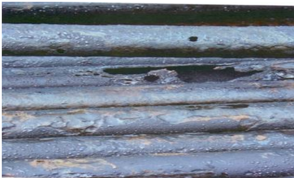
Рисунок 3 - Коррозия НКТ в нагнетательной скважине сточной воды произошла снаружи и изнутри
