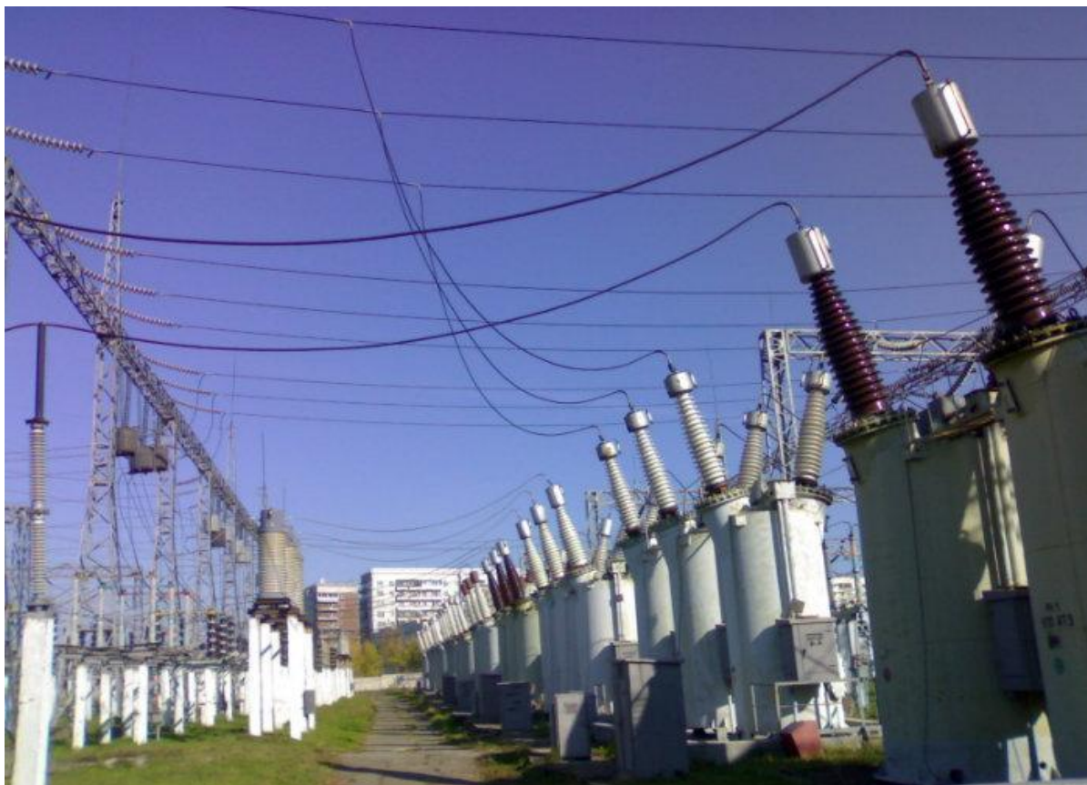
Рисунок 1- Электрическая подстанция "Восточная" г.Томск
