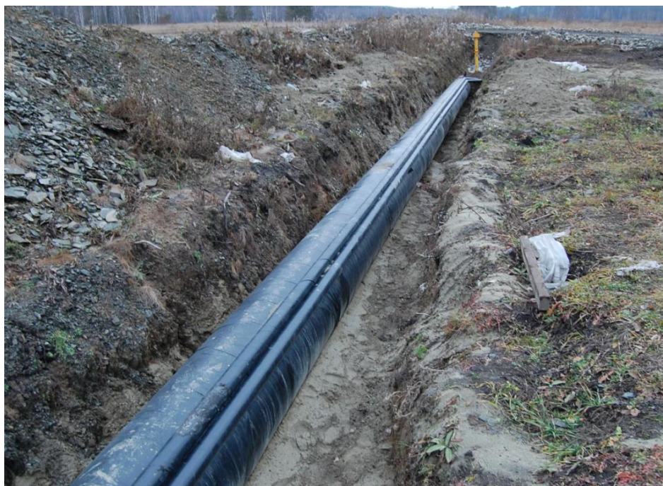
Рисунок 1 – Размыв участка газопровода – отвода к ГРС-1 г. Томска.
