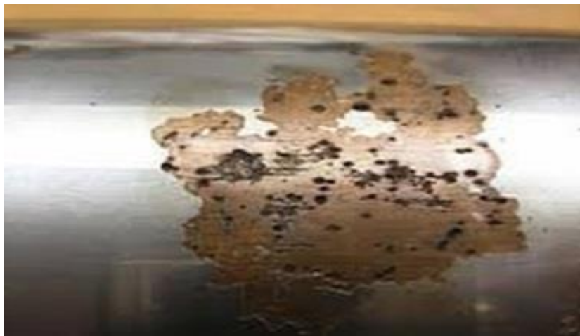
Рисунок 5 - Местная коррозия (точками)
