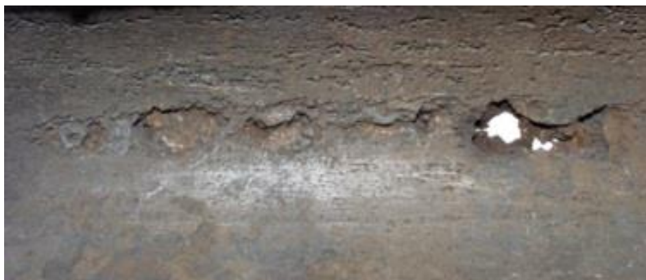
Рисунок 13 - Общий вид участка трубы с дефектами
