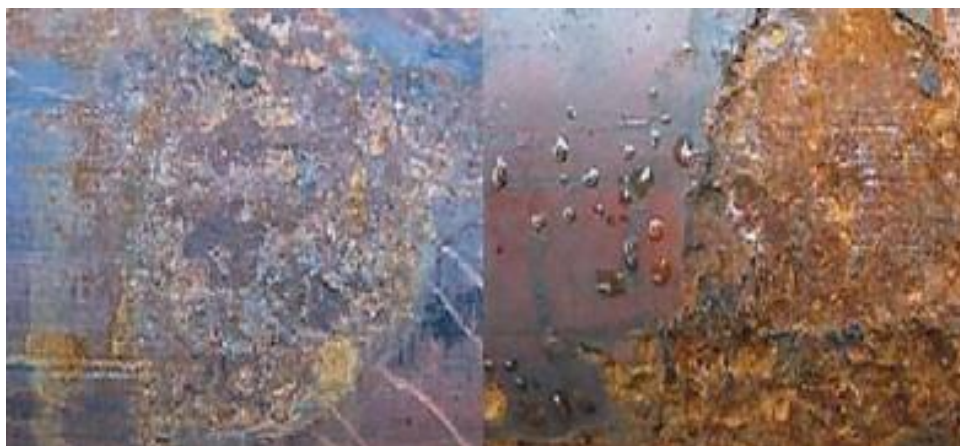
Рисунок 4 - Местная коррозия (пятнами, язвами)
