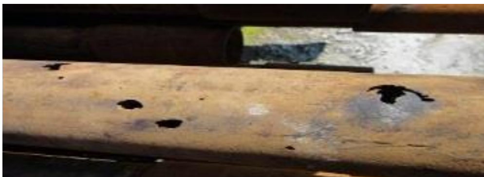
Рисунок 9 - Сквозная коррозия стенки насосно-компрессионной трубы
