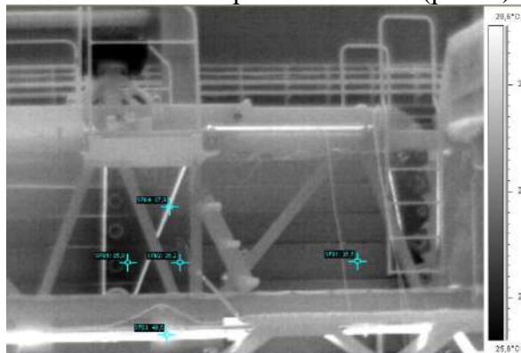
Рис. 1. Термограмма испытаний подъемника, начало подъема.
