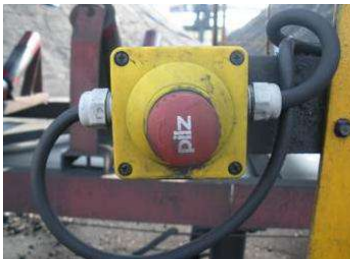
Рис.1. Кнопка аварийной остановки.
