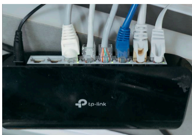
Рисунок 17 – Коммутатор, к которому подключен ПЛК
