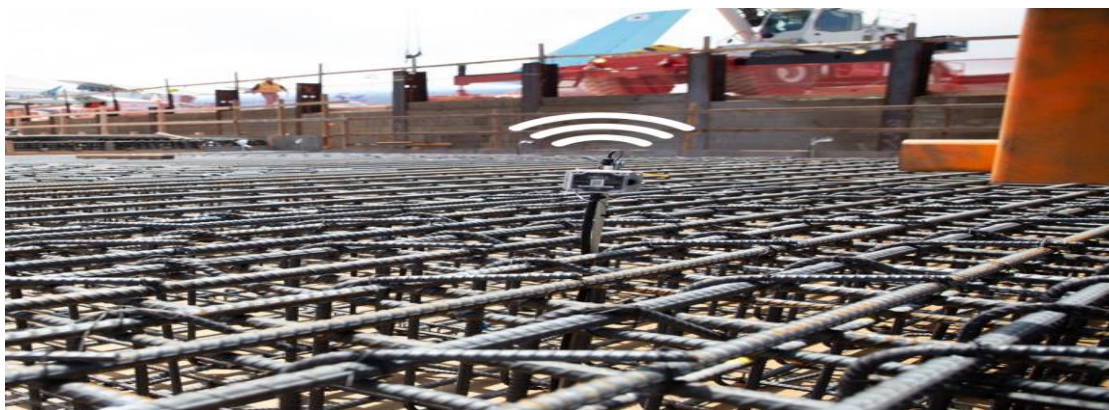
Рисунок 10 - Датчики состояния бетона
