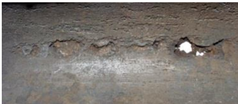
Рисунок 13 - Общий вид участка трубы с дефектами
