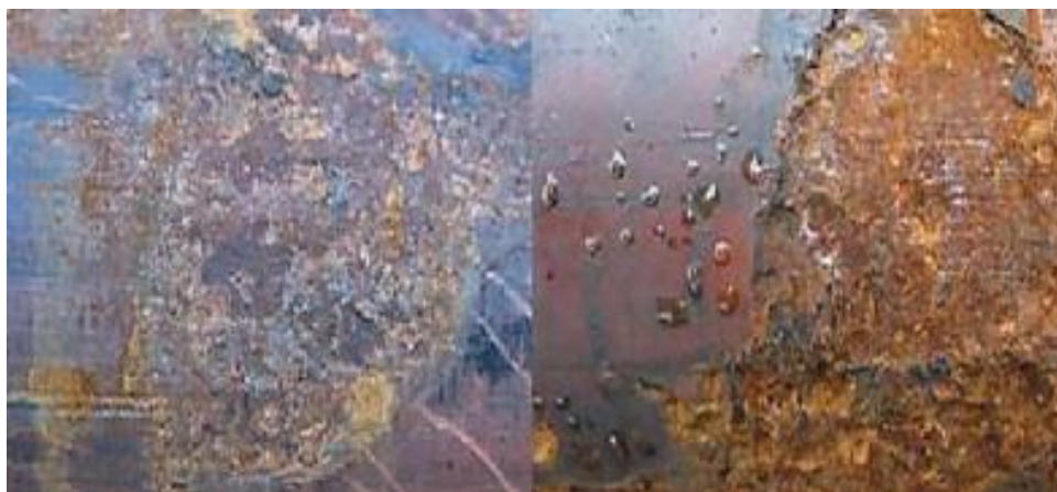
Рисунок 4 - Местная коррозия (пятнами, язвами)
