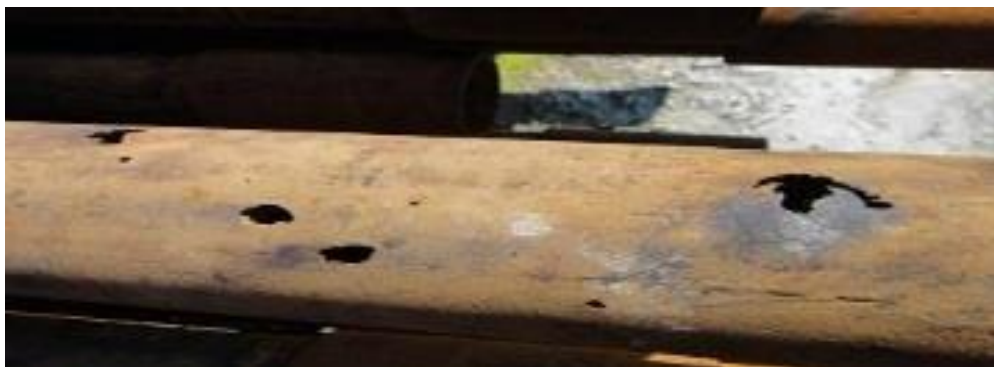
Рисунок 9 - Сквозная коррозия стенки насосно-компрессионной трубы
