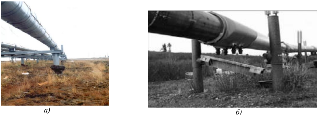
Рис. 1. Последствия промерзания грунта: а – выпучивание грунта и смещение опоры, б – поломка опоры
