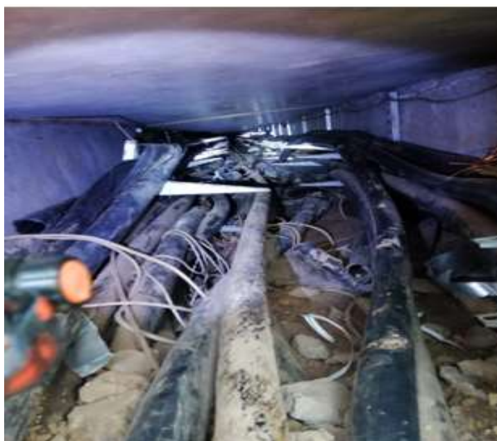
Рисунок 5К - Кабельный канал [188]
