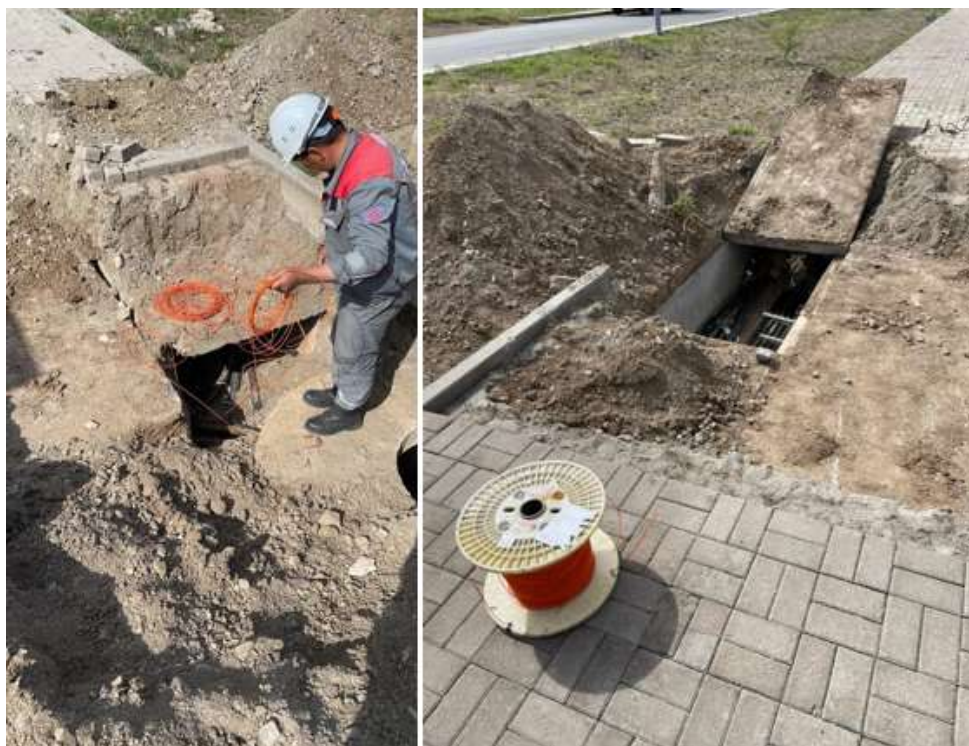
Рисунок 8К - Монтаж волоконно-оптических датчиков [187-189]
