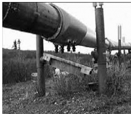
Рис. 1. Последствия морозного выпучивания опор надземного трубопровода
