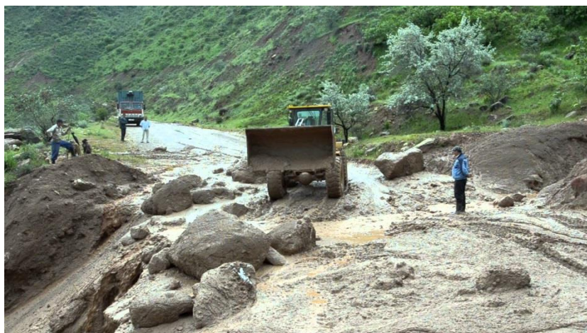
Рисунок 2.2 – Уборка дороги после селевого потока [1]
