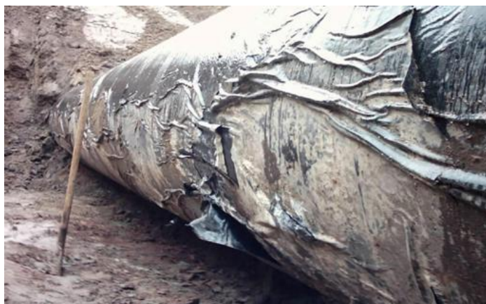
Рисунок 4 – Дефекты изоляционного покрытия [46]
