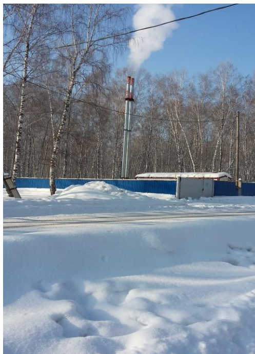
Рисунок 8 – Фотография котельной на газе (село Кожевниково), (фото Таловской А. В.)
