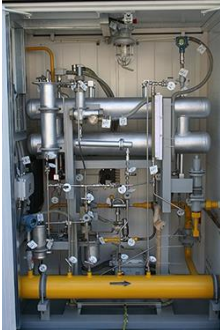
Рисунок 19 – Фото установки БАОГ смонтированной на выходном трубопроводе ГРС
