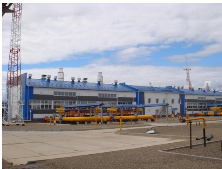
Рисунок 1–Компрессорная станция «Вертикос»
