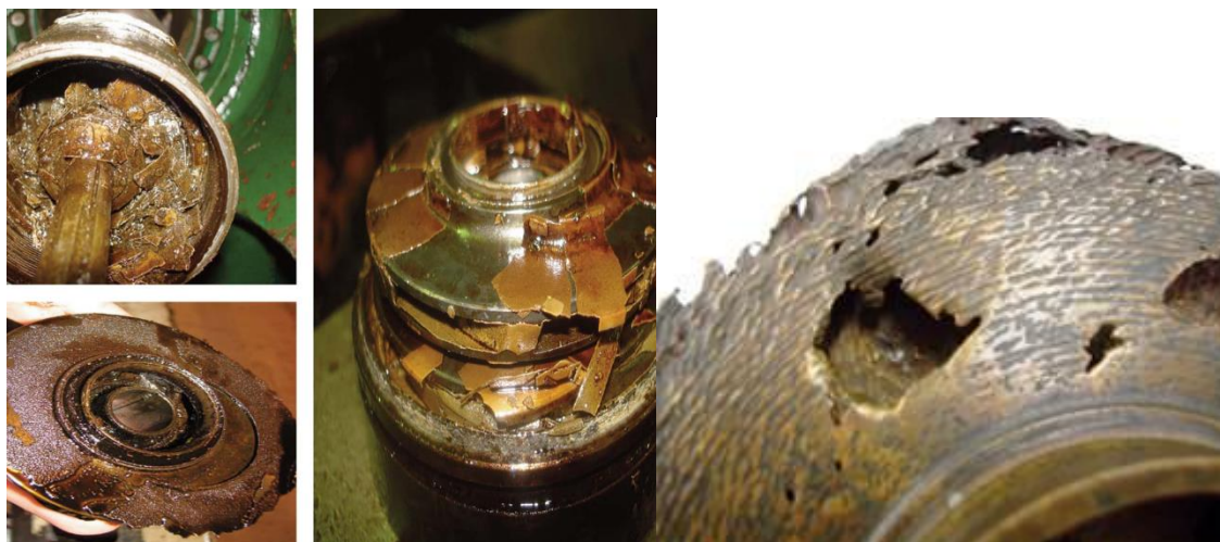
Рисунок 2 – Засорение и износ рабочих колес центробежного насоса
