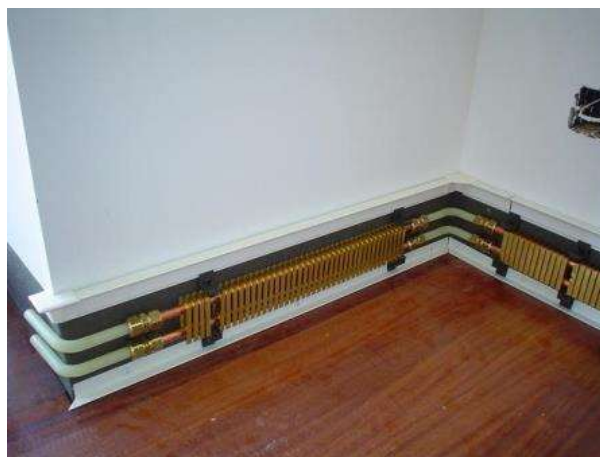
Рисунок 9. Плинтусные радиаторы отопления
