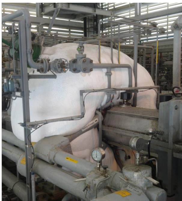
Рисунок 48 – Обмерзание ВНА и секции низкого давления компрессора
