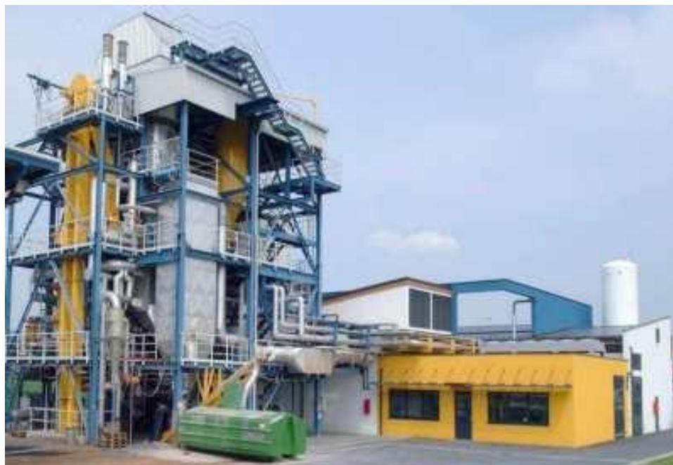
Рисунок 1.14 - Газификатор древесных отходов в кипящем слое в Gussing, Австрия
