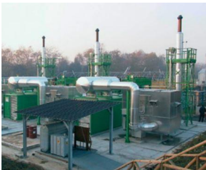
Рисунок 1.18 - Контейнерная установка J312
