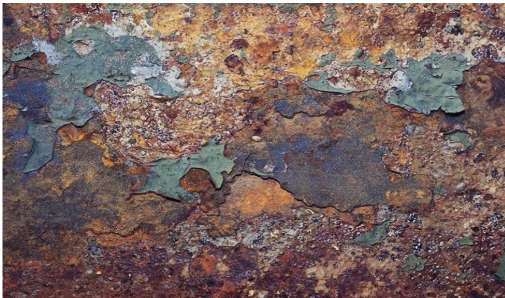
Рисунок 2 – Пример коррозии на поверхности металлической трубы
