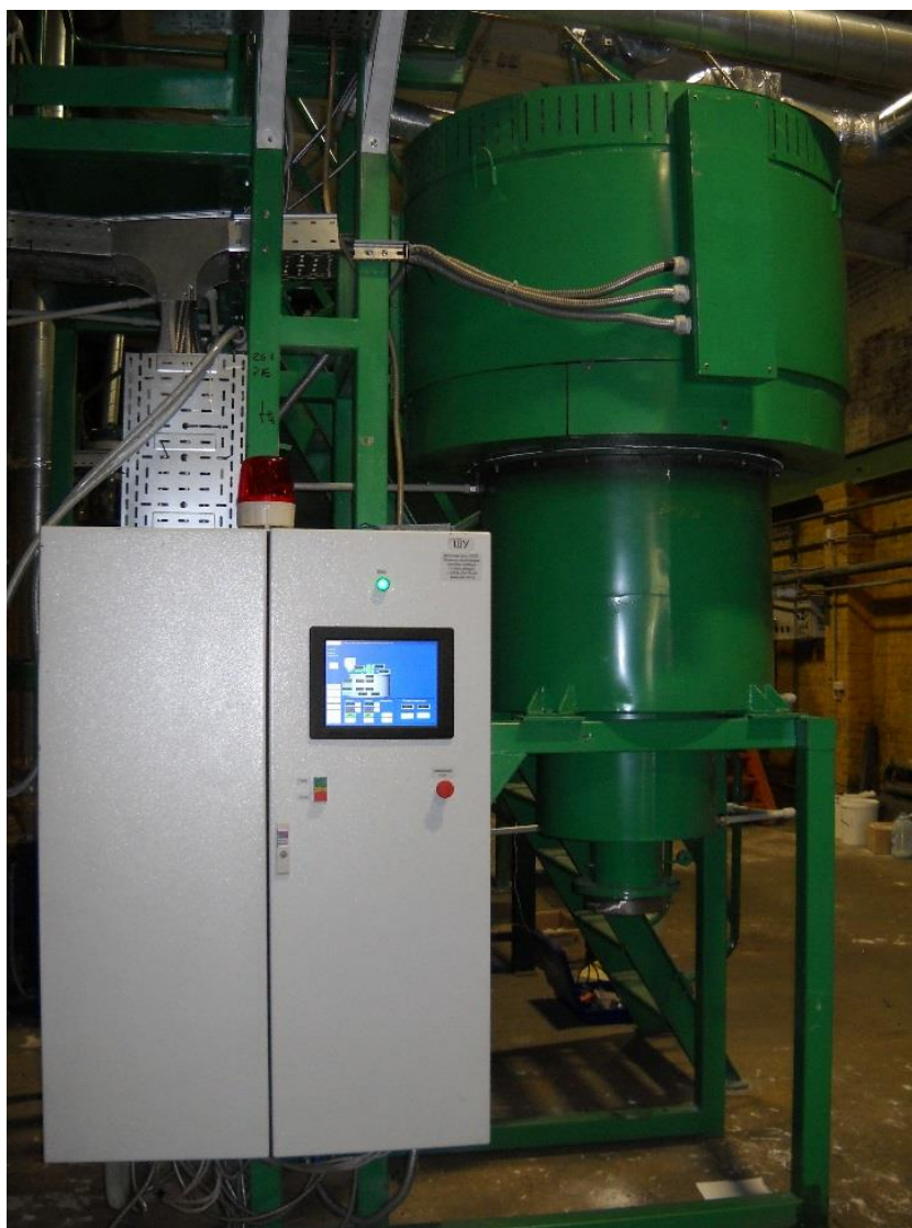
Рисунок 3.14 – Усовершенствованный центробежный реактор барабанного типа ЦЕФЛАР™ после проведения шеф-монтажных работ на территории ООО «Кит-Строй СПб» (г. Санкт-Петербург)
