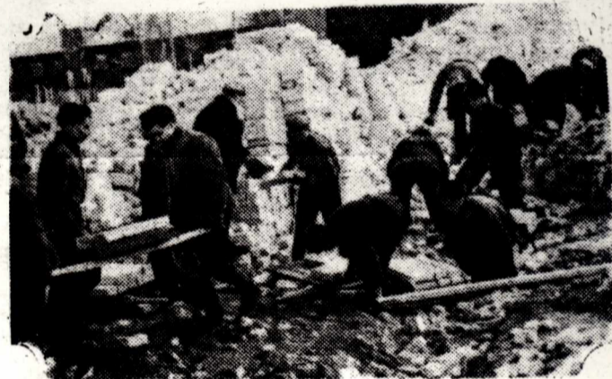
Возобновилась достройка нового горного корпуса. Активное участие в строительстве принимают студенты. Не одну тысячу кирпича разгрузили они. На снимке: студенты за работой. Фото В. Ратникова.
