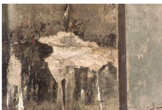
Рис. 1. Коррозия гидротехнического бетона
