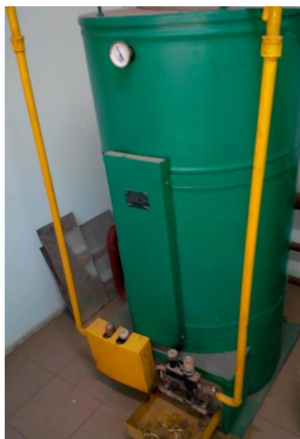
Рисунок 10– Типовой газовый котёл отсека подготовки теплоносителя ГРС-Ч «Урожай-20»
