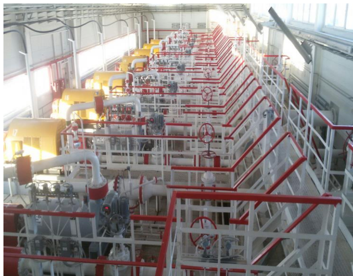
Рисунок 1 – Кустовая насосная станция
