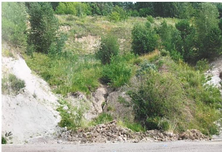
Рисунок 4 – Оползневой цирк № 1 на участке «Лагерный сад», г.Томск [9]
