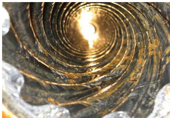
Рисунок 9 – Дефекты на роторе после эксплуатации на солевом растворе
