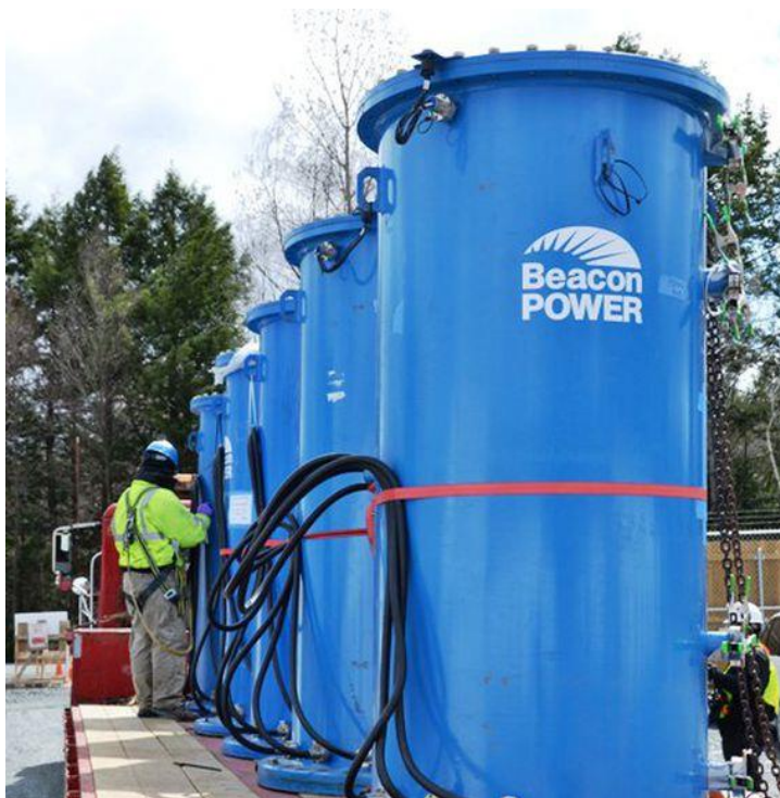
Рисунок 1 –Накопитель энергии Beacon Power
