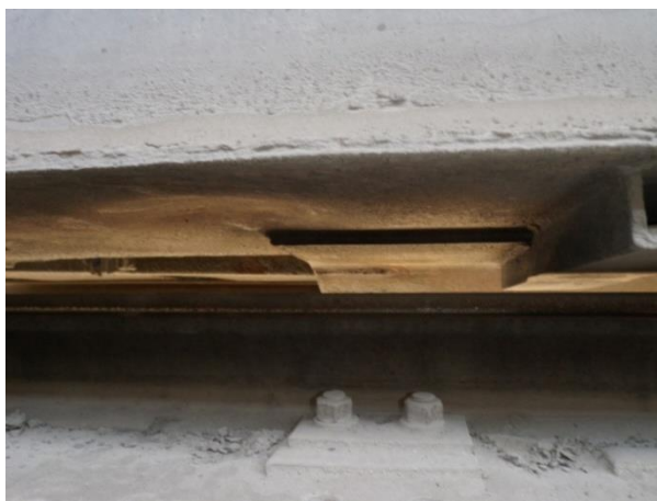
Рисунок 16 – Нижняя фасонка соединения шарнира и стрелы. Трещина длиной 100мм в ремонтном сварном шве фасонки.
