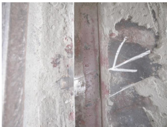
Рисунок 15 -Верхний пояс стрелы. Трещина в ремонтном сварном шве в зоне ремонтной накладки в средней части стрелы (видимая длина трещины 50мм).
