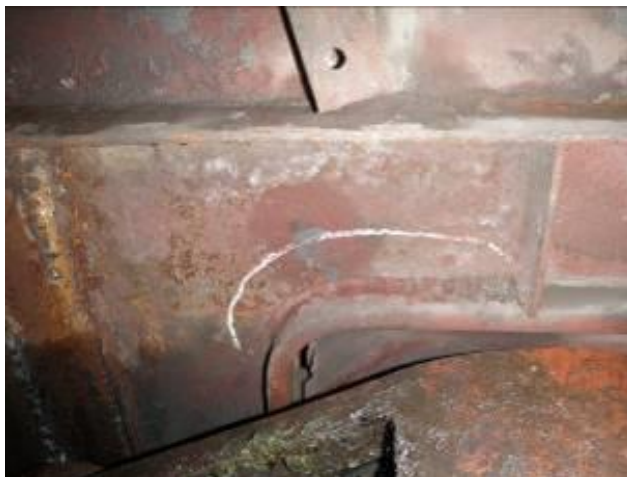
Рисунок 14 -Узел крепления гнутого листа буксовой зоны к внутренней стенке балки в зоне приводного ходового колеса. Трещина в сварном шве.
