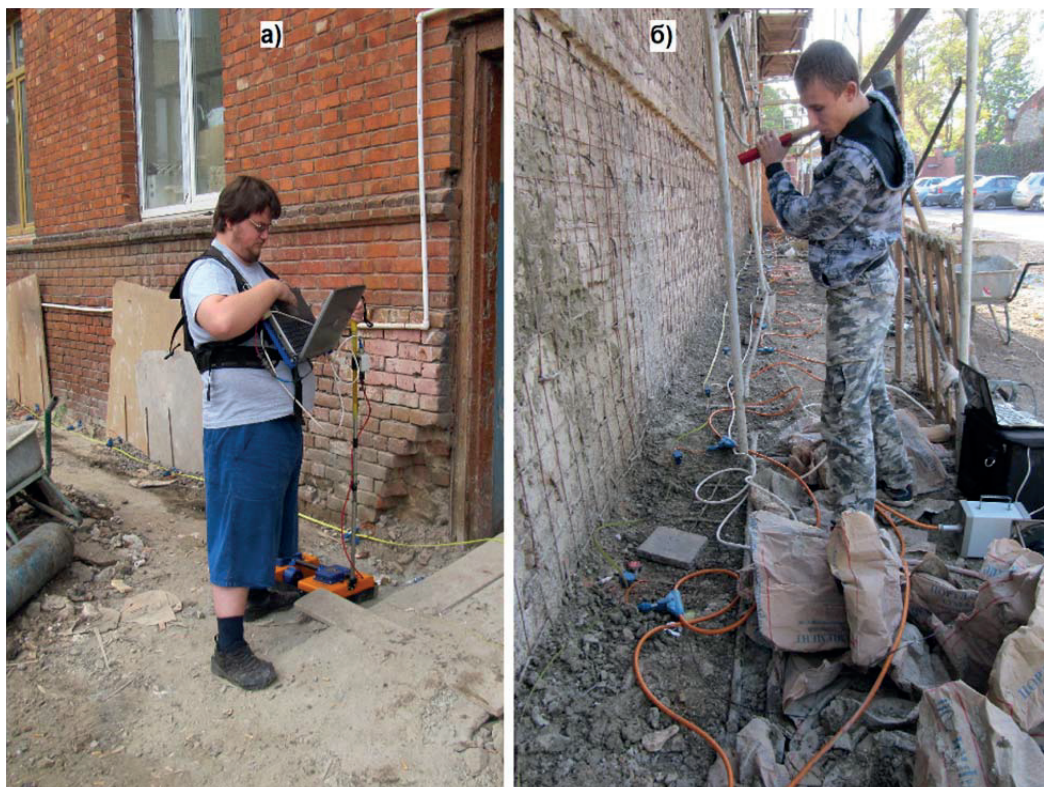
Рис. 6. Условия проведения РЛЗ (а) и МПВ (б) на территории размещения здания МУЗ «Городская поликлиника № 2»
