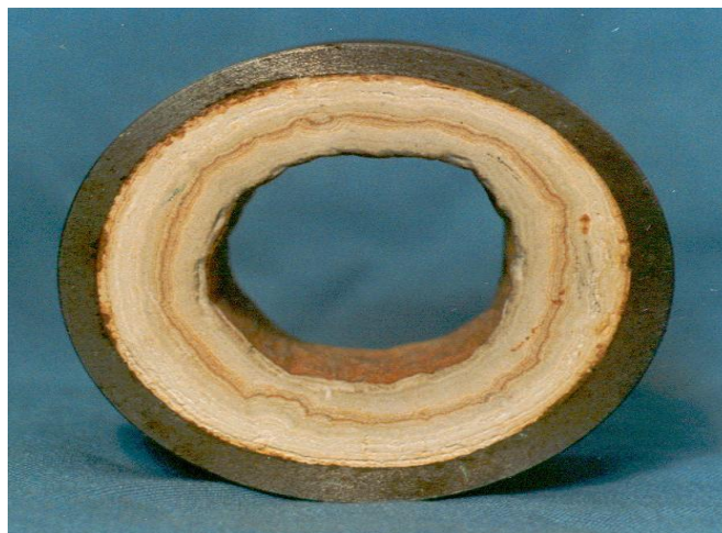
Рисунок 1 – Отложение солей на трубопроводе
