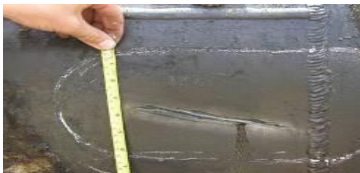
Рисунок 1 – Комбинированный дефект на стенке трубопровода
