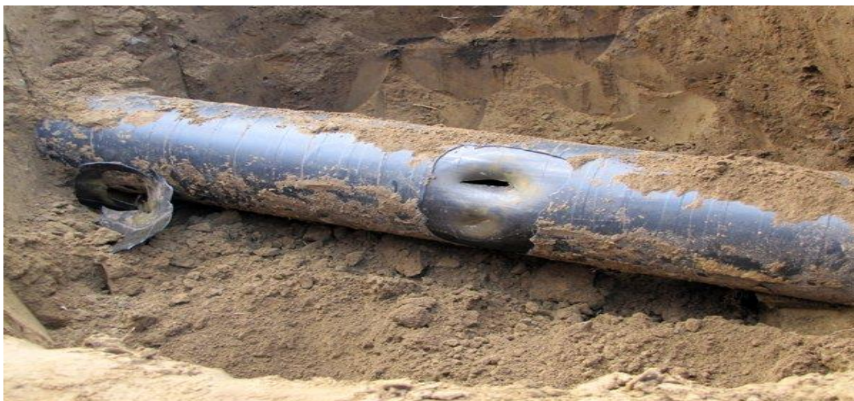
Рисунок 12 Дефектный участок газопровода
