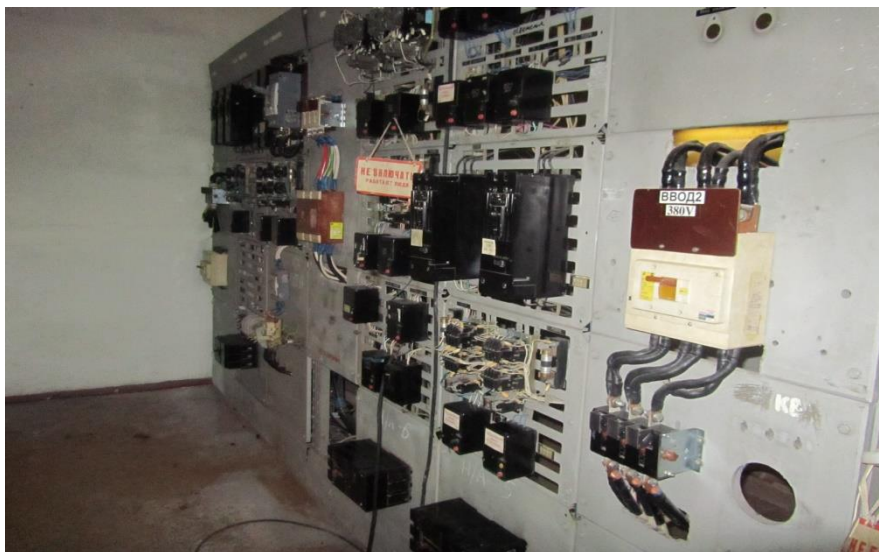
Рисунок 13 - Электрощитовая насосной станции.
