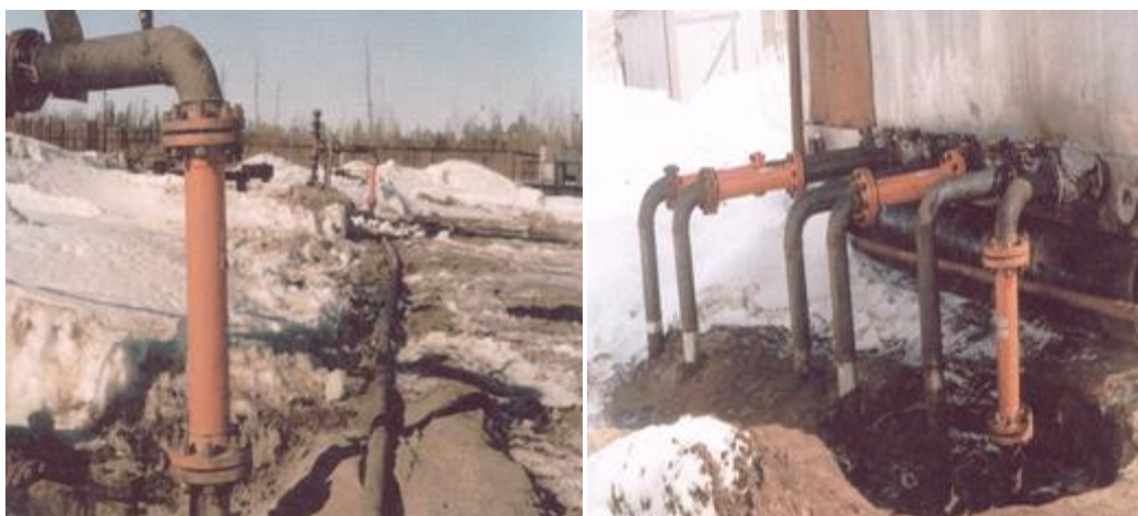
Рисунок 15 - Магнитные камеры на устье и на входе в АГЗУ
