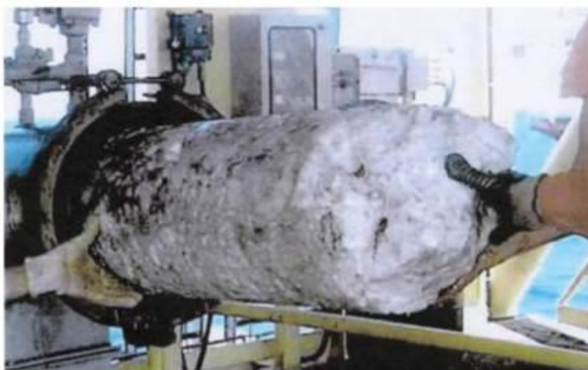
Рисунок 1.2- Образовавшаяся в трубопроводе гидратная пробка
