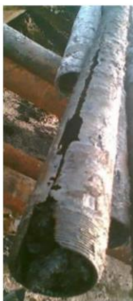
Рисунок 6 – Разрушение НКТ в результате коррозии
