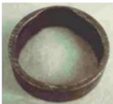
Рисунок 5 – Участок трубы с истончившейся стенкой
