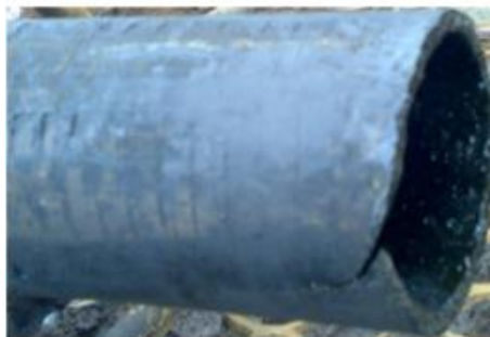
Рисунок 4 – Повреждение трубы в результате механических повреждений
