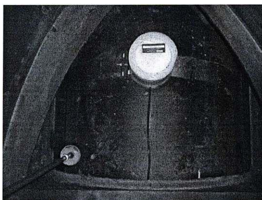
Рисунок 15 – Накладной преобразователь температуры с термоизолирующим колпаком, установленный на поверхность трубопровода
