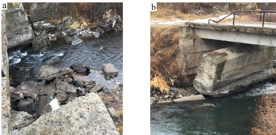
Рис. 1. Разрушенная опора моста: а) вид с верхнего бьефа; б) вид с нижнего бьефа Fig. 1. Destroyed support of the bridge: a) view from upstream; b) view from downstream
